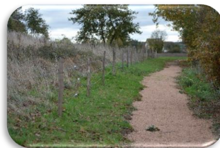
Une clôture a été réalisée au stade pour sécuriser la nouvelle allée vers l'aire de jeux
